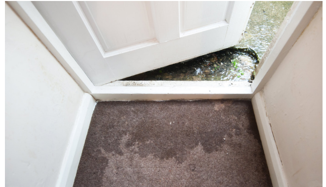
Abb. 6: Wasserschaden an Türöffnung
