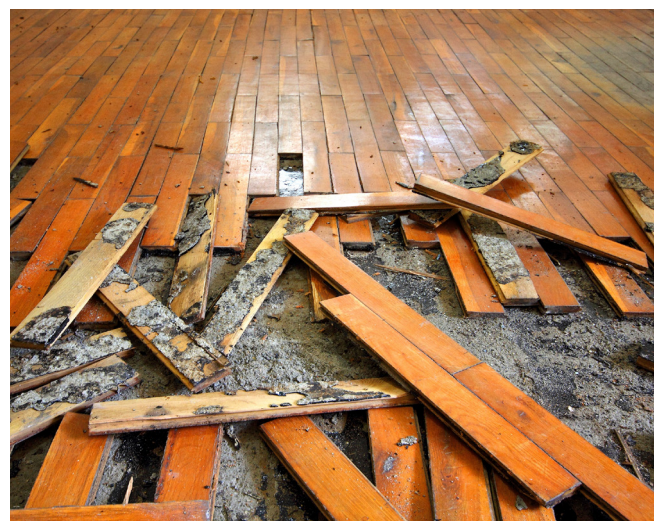
Abb. 45: Schäden durch Stauwasser
